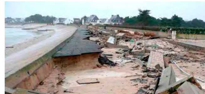
Rupture d'ouvrage de protection à Gâvres - Mars 2008 - Photo DDTM 56 (Erwan le Cornec GEOS)
