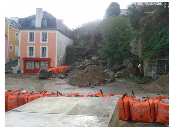
Eboulement à Sauzon en 2016 - Photo DDTM 56
